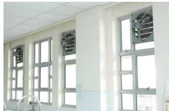
Ventilasi dan kipas sirkulasi udara di dalam laboratorium
